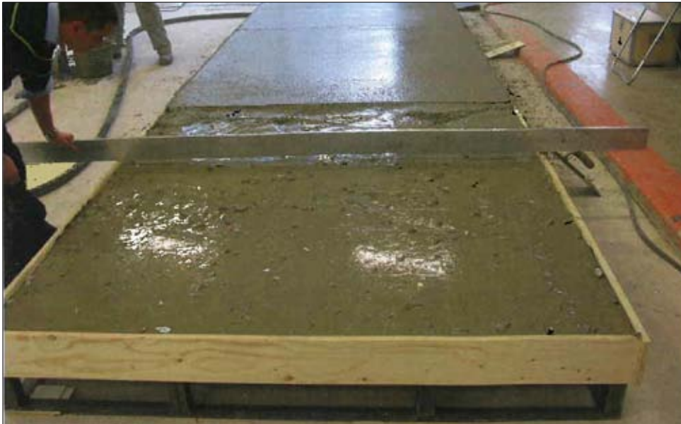
Figur 9. Gjutning med ortens ballast i nedre delen av golvet syns i främre delen av formen, och utvald ballast i ytan i bakre delen. Gjutningen sker vått i vått. Den främre delen fylldes också med utvald ballast strax efter det att fotot tagits.
