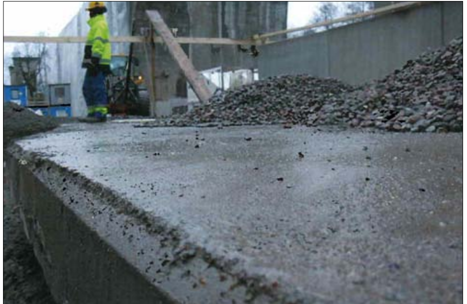
Figur 6. Färdig yta som används som stenupplag. Notera perfekt avtryck av trekantslist utan vibrering av formen. Foto: Jonatan Paulsson-Tralla
